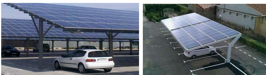
Figura 27. Imagem ilustrativa de painéis em estacionamento
